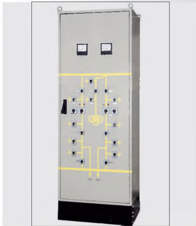
Шкаф реле и управления выключателями
