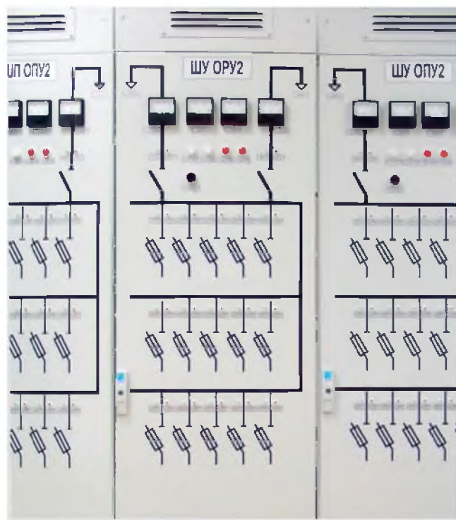
Шкафы отходящих линий ЩПТ
