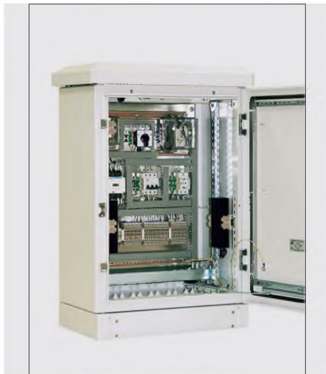
Шкаф охлаждения трансформатора
