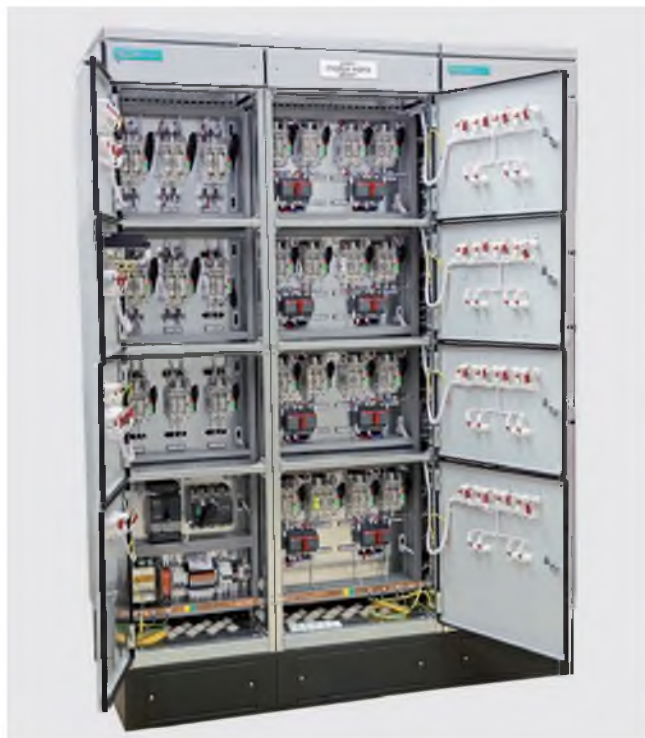
Шкаф отходящих линий ЩПТ с секционированием на базе рубильников с предохранителями
