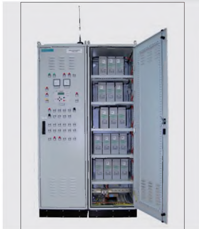
СОПТ типа ШОТЭ из двух шкафов: шкафа оперативного тока ШНЭ8003 и шкафа аккумуляторного ШНЭ8004
