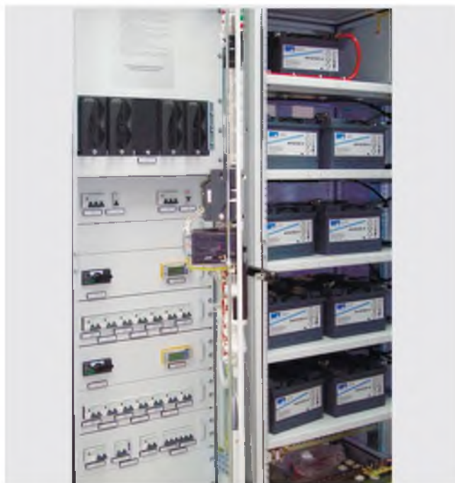
Распределенная СОПТ типа ШОТЭ (вид спереди, открытая дверь), состоящий из шкафа ШНЭ8003 (слева) и шкафа ШНЭ8004 (справа)
