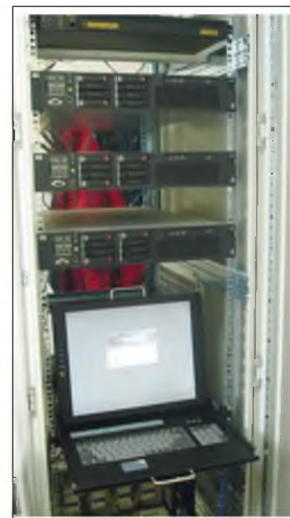
Шкаф серверов БД ПС «Амет»
