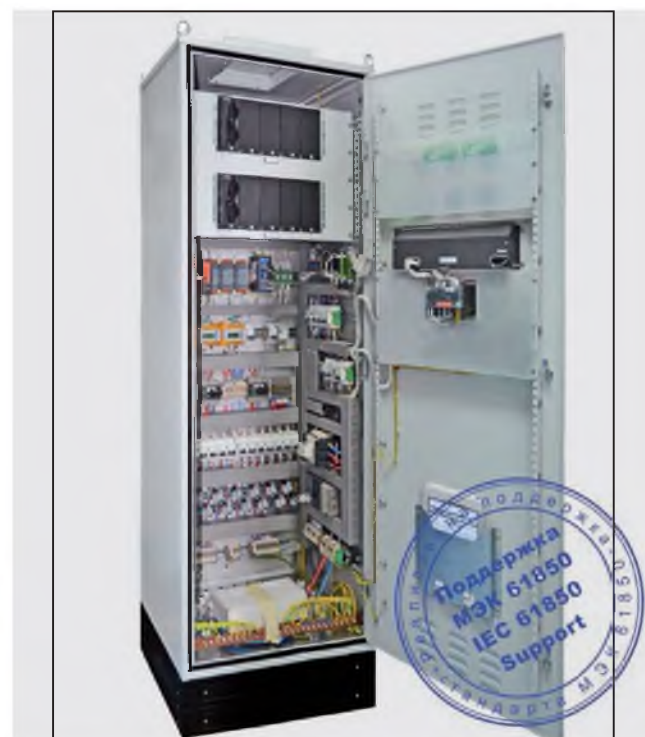
ШНЭ8003-2-20-220-92-1 УХЛ4 с зарядно-питающими устройствами Cordex и системой контроля изоляции Bender
