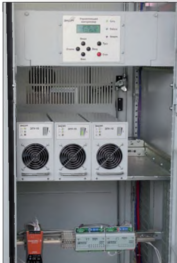
Вид смонтированной в шкафу системы питания и заряда аккумуляторных батарей на базе зарядно-питающего устройства ЗПУ-10П
