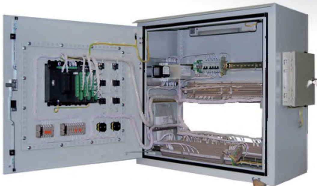
Общий вид внутреннего монтажа релейного отсека (ящик) типа ШНЭЯ1101А.1SE10-000Х с терминалом защиты генератора серии Sepam G 82 NPP фирмы Schneider Electric (атомное исполнение).
