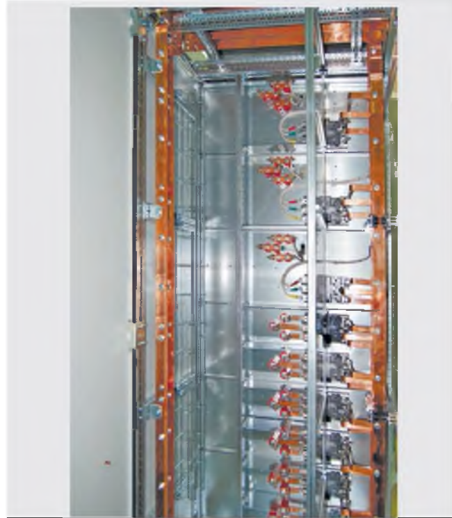
Внутреннее разделение шкафа отходящих линий ЩСН: справа – отсек шинных спусков; слева – отсек для подключения фидеров; сверху – отсек шинной сборки (закрывается защитным экраном); аппараты разделены горизонтальными защитными перегородками
