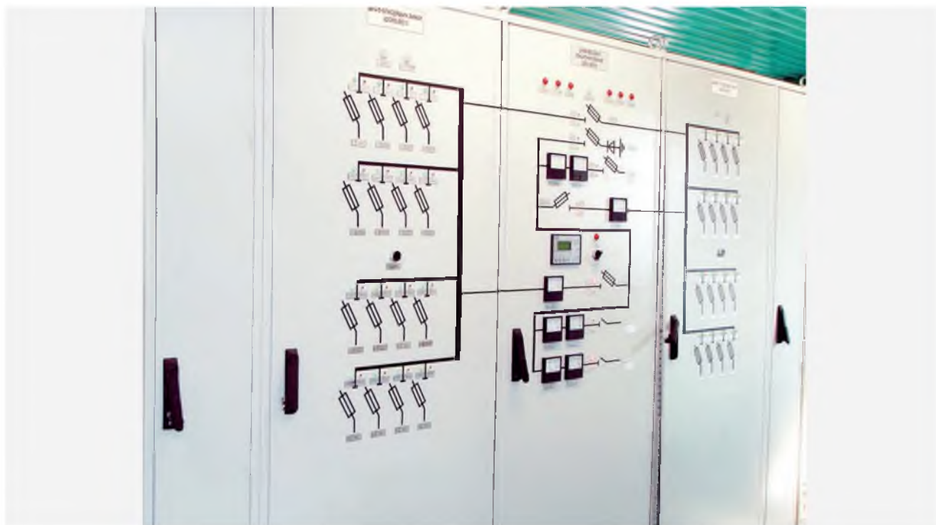
ЩПТ двухстороннего обслуживания с контролем изоляции
