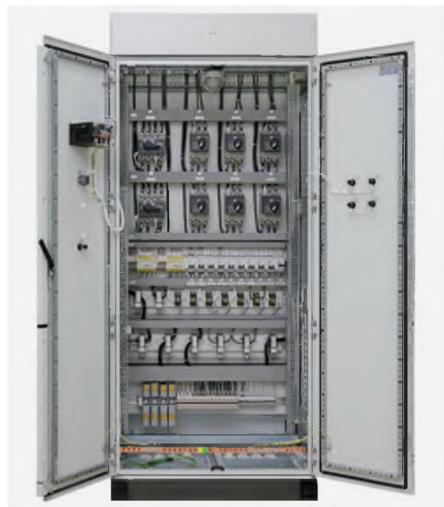
Шкаф отходящих линий на автоматических выключателях с устройствами системы контроля изоляции Bender
