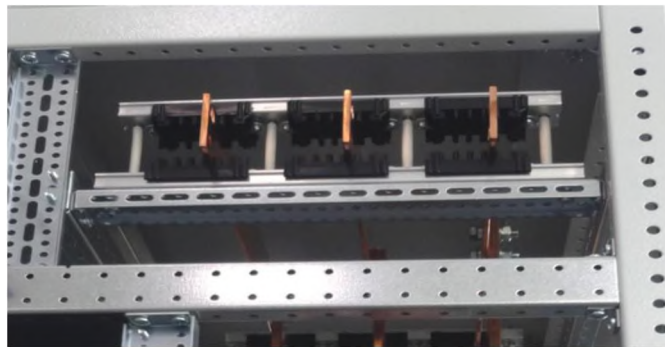
Рисунок 4.3 – Отсек горизонтальных сборных шин
